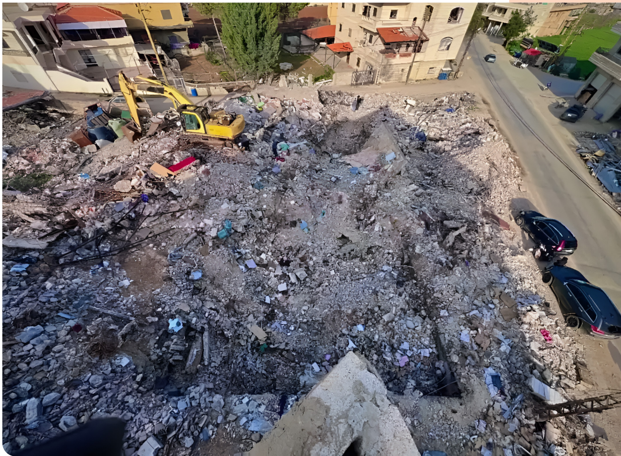
المبنى بعد قصفه
